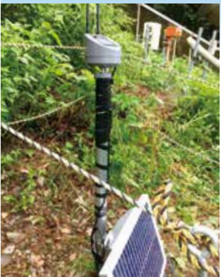
↓電力会社向け傾斜センサ設置状況
