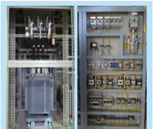
見えないところで、私たちの暮らしを支えている 配電盤・分電盤
