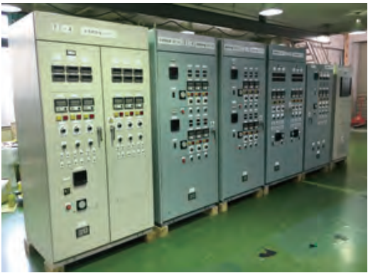
サイリスタ電力制御盤
