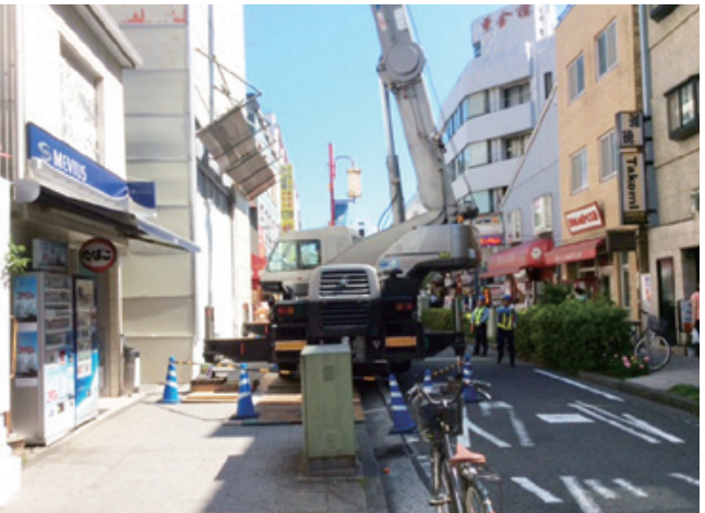
周囲の環境にも配慮を怠らず、迅速に解体工事を進める
