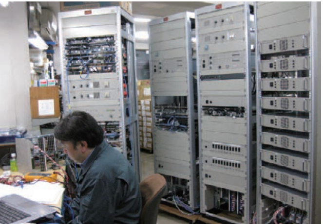
国立劇場にも導入されている業務用放送設備
