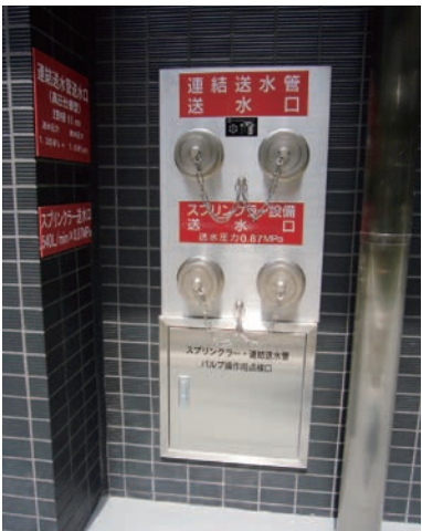
施設の防火設備に必須の連結送水管
