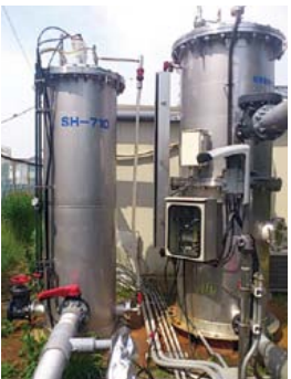
呑川水質浄化実験を行った高濃度酸素溶解装置
