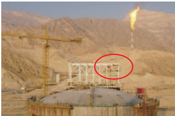
カタールのLNGタンク ○囲みの赤い機械が同社製品(モノレール式:移動式)
