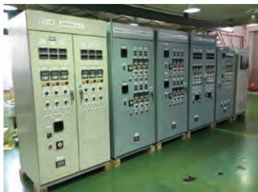
サイリスタ電力制御盤
