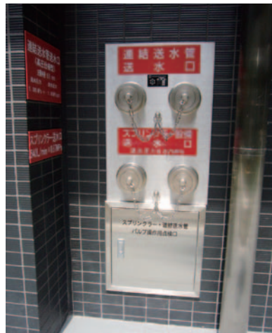
施設の防火設備に必須の連結送水管
