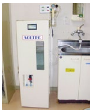
「SOLTEC」の設置事例
