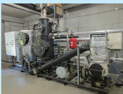
<小型木質バイオマス熱源兼発電機>
