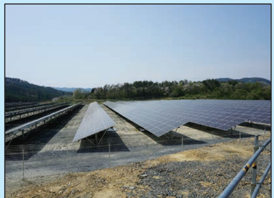
<メガソーラー 米川鷹ノ子発電所>
